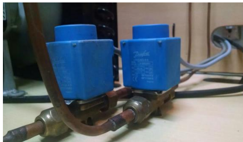
Figura 15. Válvulas solenoides del banco de pruebas
