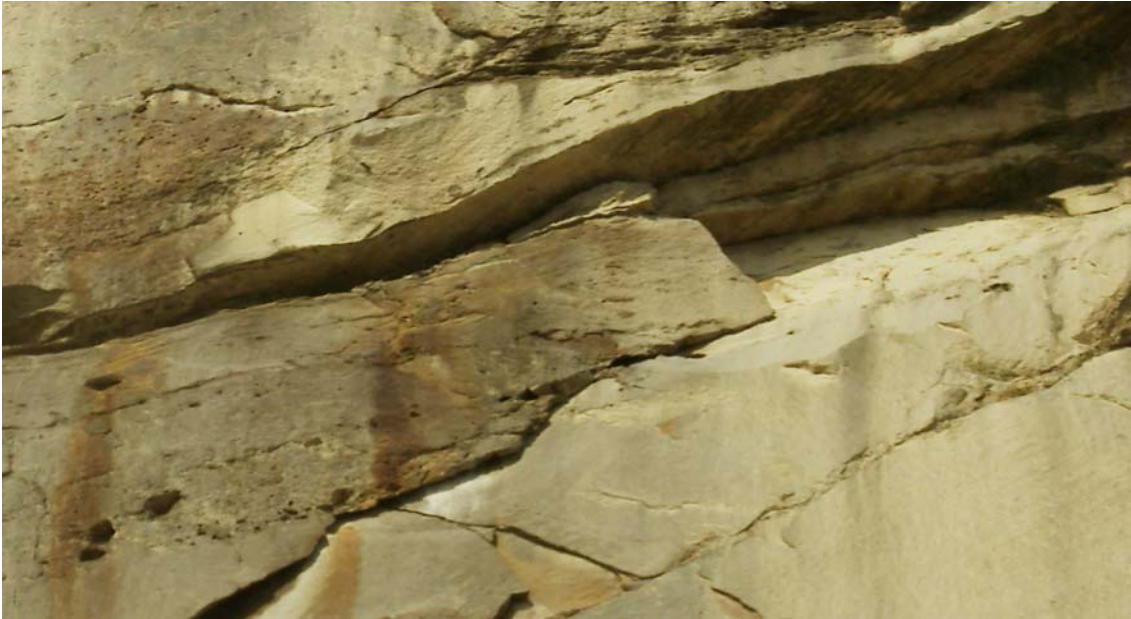
Foto 36: Bloques de roca salientes del talud
