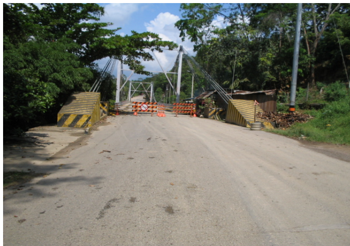
Foto 41: Señalización de cierre total de la vía Visto desde la carretera Barrancabermeja - Bucaramanga
