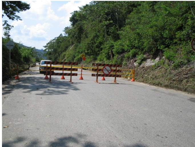
Foto 42: Señalización de cierre total de la vía Visto desde la carretera Bucaramanga –Barrancabermeja
