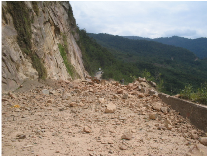
Foto 49: Escombros luego de la explosión
