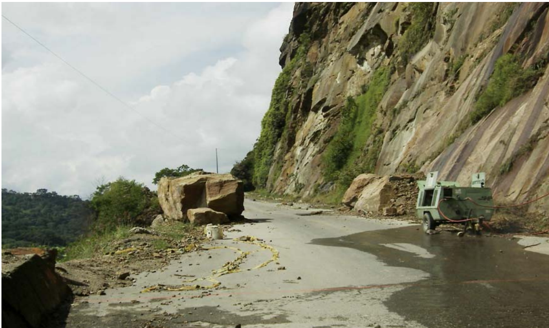
Foto 33: Caídos de roca sobre la vía
