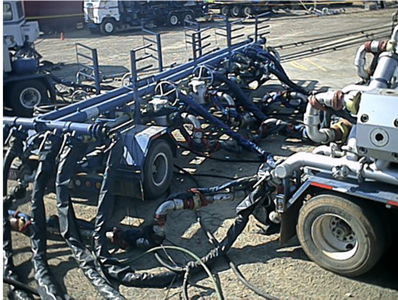
Figura 107. Manifold de descarga o succión de los fracturadores
