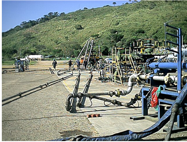
Figura 114. Líneas de alta presión
