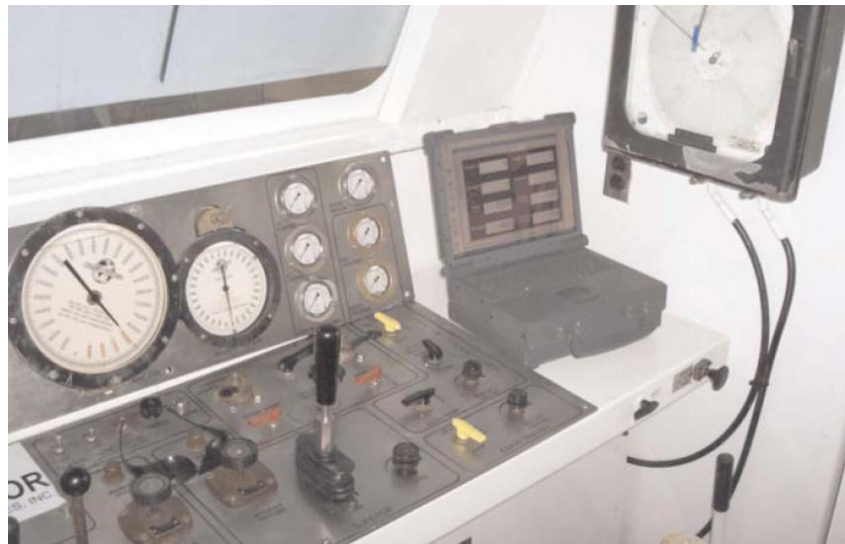
Figura 6. Cabina de Control.
