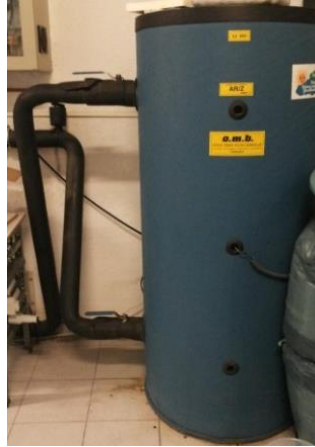
Figura 66. Tanque de almacenamiento.
