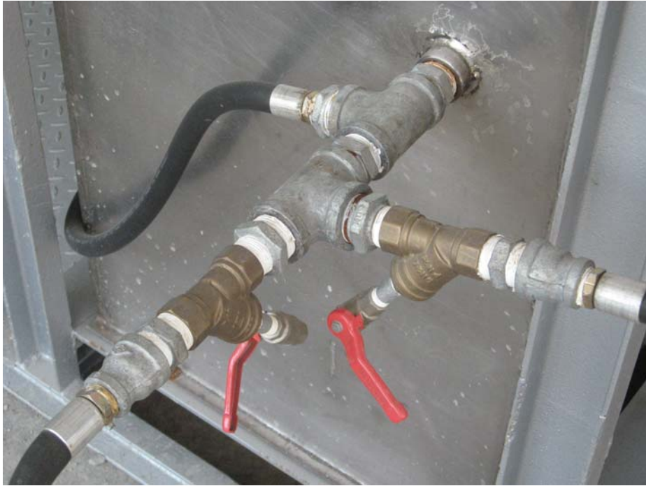
Figura 08. Filtros en y del sistema hidráulico ubicados en la línea de retorno a tanque
