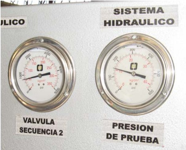
Figura 112. Presión de trabajo en el sistema hidráulico y del sistema oleohidráulico para la prueba de un accesorio tipo cruz de 8" X 6".
