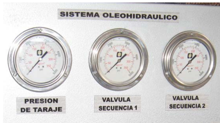
Figura 79. Conjunto de manómetros del sistema oleohidráulico
