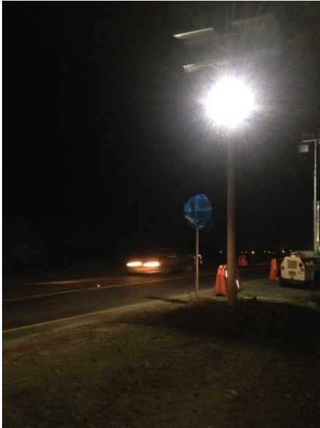
Figura 17. Sistema de iluminación solar en operación
