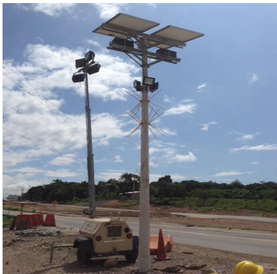
Figura 14. Comparación de sistemas solares vs luminaria diesel
