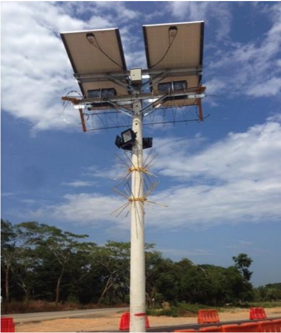
Figura 16. Sistema de iluminación solar instalado
