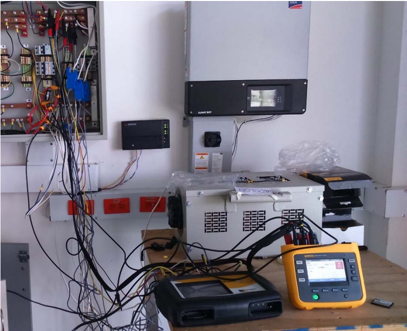
Ilustración E5. Medidores DRANTZ POWER VISA Y Fluke 1730 conectados al tablero AC1.
