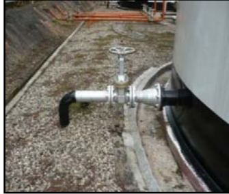
Fotografía 4. Tubería de salida de crudo
