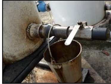
Fotografía 17. Fuga leve en la unión a llave de paso del ASEP-5008022
