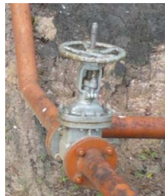
25 b) válvula de tubería de gas.
