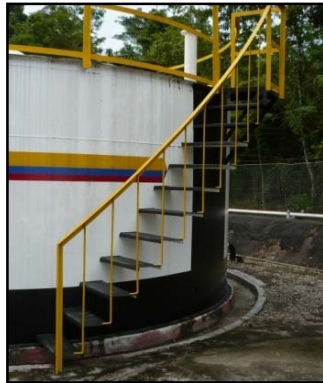
11 a) Escalera tanque K-01
