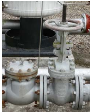
25 a) Válvula de tubería de crudo.
