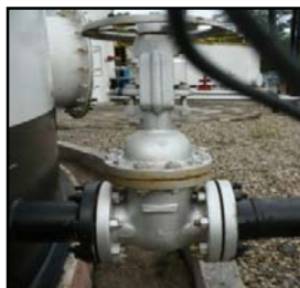
Fotografía 3. Tubería de entrada de crudo
