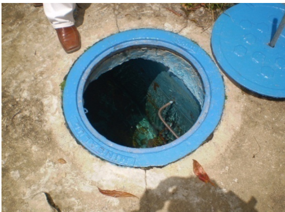
Imagen 7: Tanque de almacenamiento.
