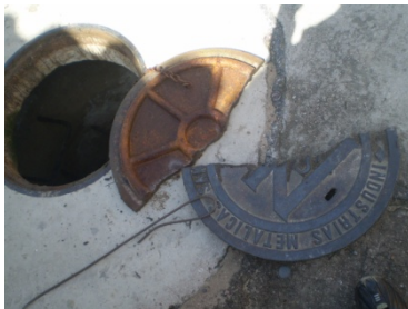
Imagen 9: Tapas fracturadas del alcantarillado.
