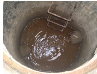
Imagen 10: Pozo colmatado del alcantarillado.
