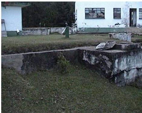
Fig. 15 Tanque de almacenamiento
