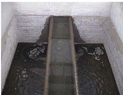
Fig. 13 Canaleta de repartición
