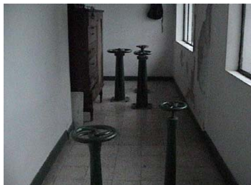
Fig. 14 Válvulas manejo de filtros
