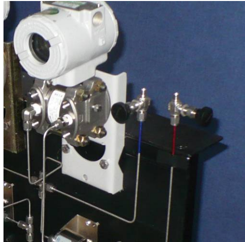
Figura 47 Válvulas De Entrada De Presión Al Banco De Permeabilidad
