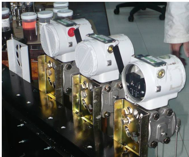
Figura 86 Detalles Montaje De Los Medidores De Presión Diferencial
