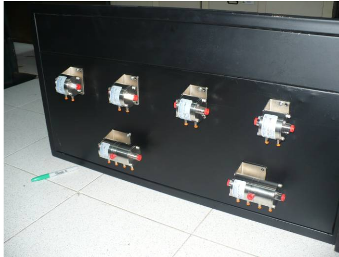
Figura 33 Montaje de Válvulas Hidráulicas
