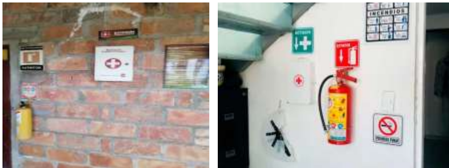
Zona de extintor y botiquín
