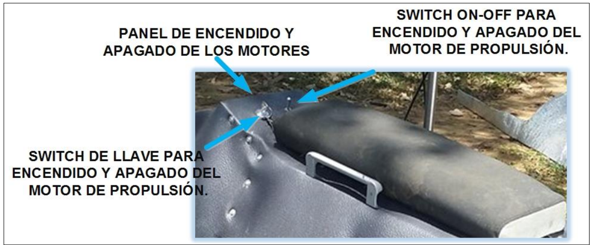
Figura 69. Panel de encendido y apagado de los motores.
