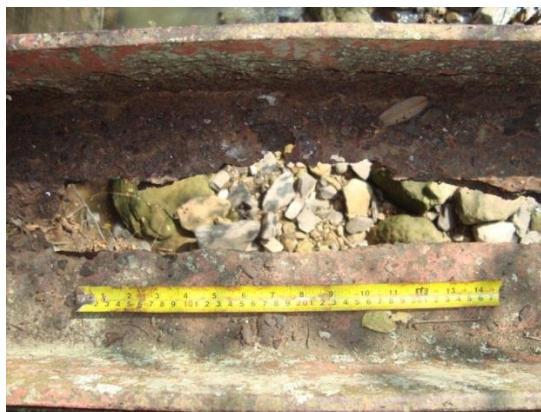
Figura 41. Elemento corroído puente Salamaga
