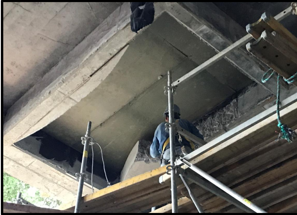
Figura 67A.8 cambios de las formas de vigas deformes. Fuente: Autor
