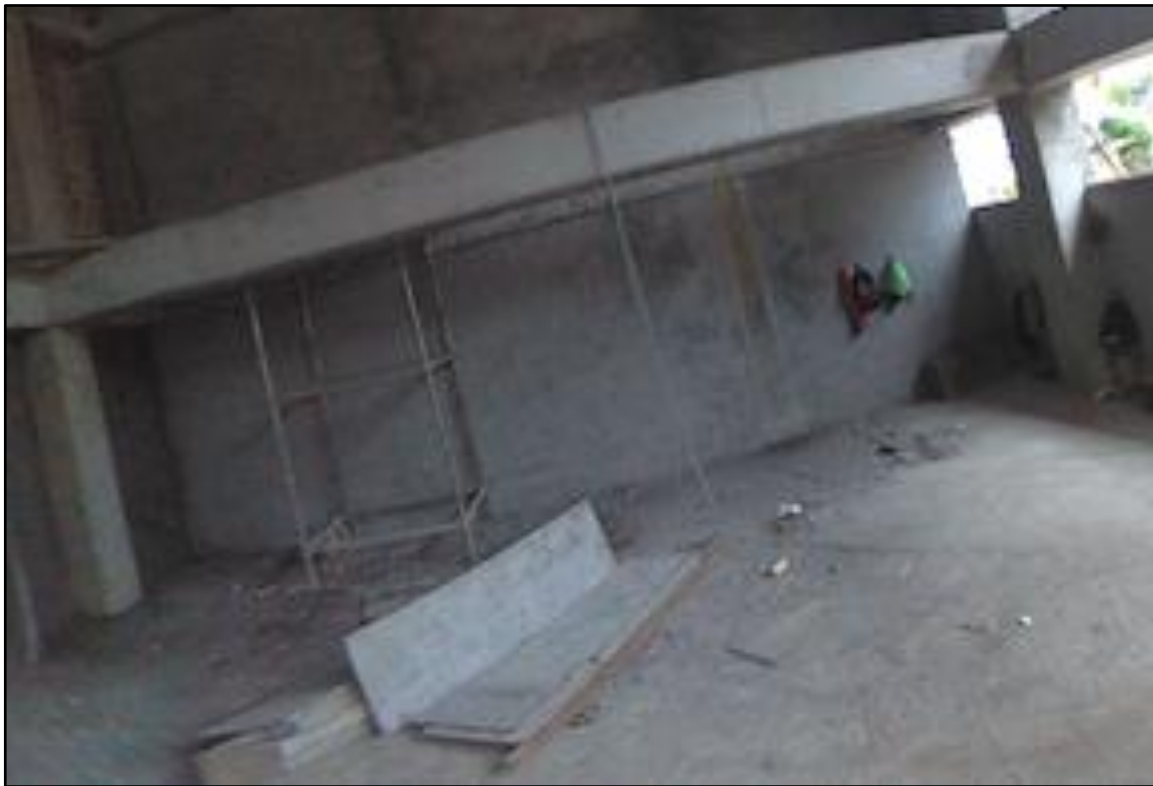
Figura A22.1 Avance del ítem correspondiente a los frisos de muros internos. Fuente: Cámara de 360 grados del grupo de investigación Geomatica.
