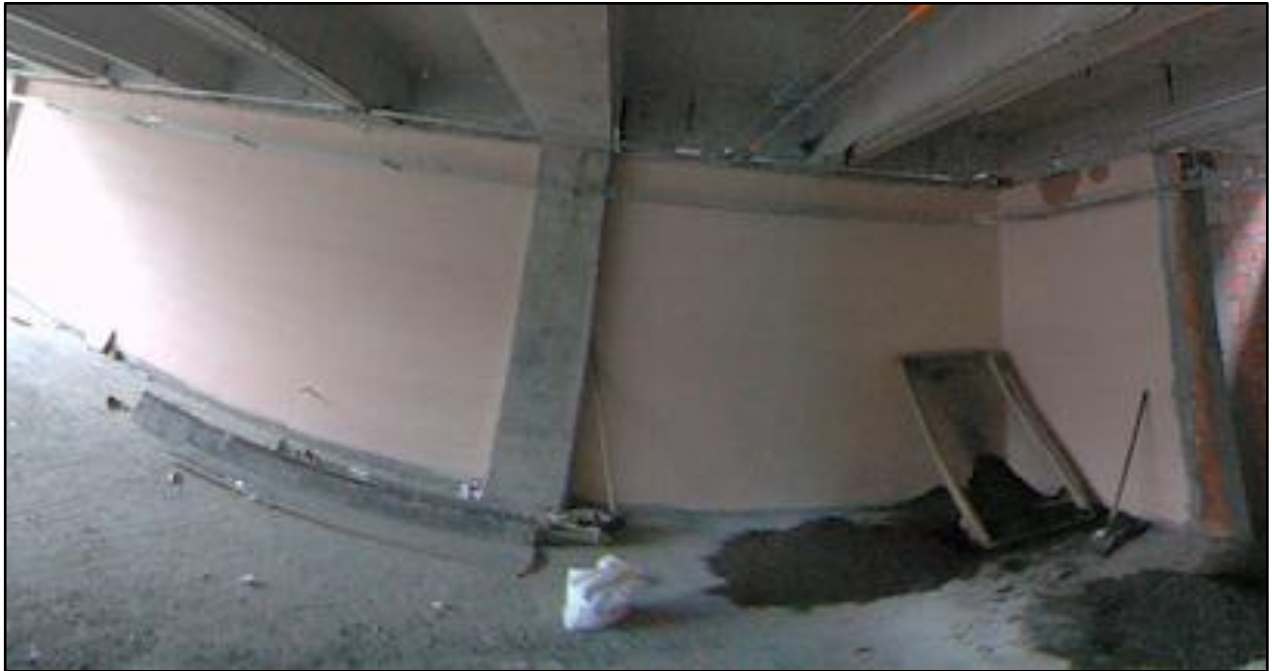
Figura A21.1 Avance del ítem correspondiente al estuco. Fuente: Cámara de 360 grados del grupo de investigación Geomatica.
