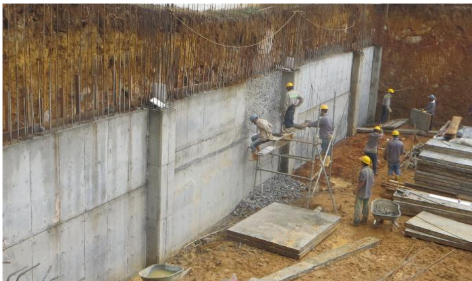
Figura 67A.3 Reparacion en muro de contencion sobre el eje P. Fuente: Autor
