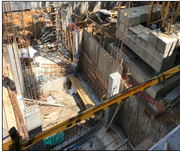
Figura A9.1 Avance del ítem correspondiente a las columnas. Fuente: Camara de alta definición.
