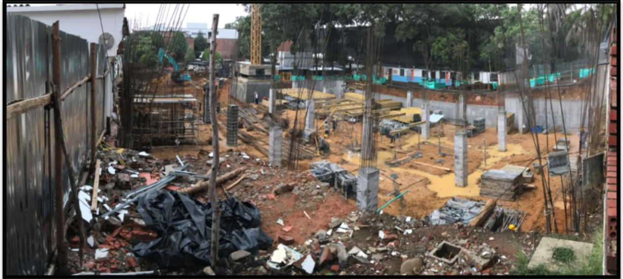
Figura 67A.9 Partes de la obra inundadas por las fuertes lluvias. Fuente: Autor
