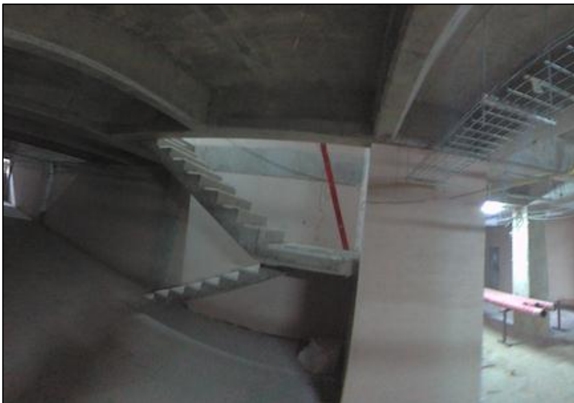
Figura A16.1 Avance del ítem correspondiente a las escaleras tipo 3. Fuente: Camara de 360 grados del grupo de investigacion Geomatica.
