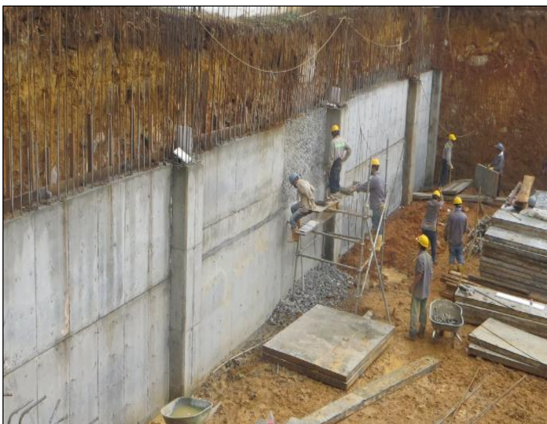
Figura A.7.1 Avance del ítem correspondiente a los muros de contención. Fuente: Cámara de alta definición.
