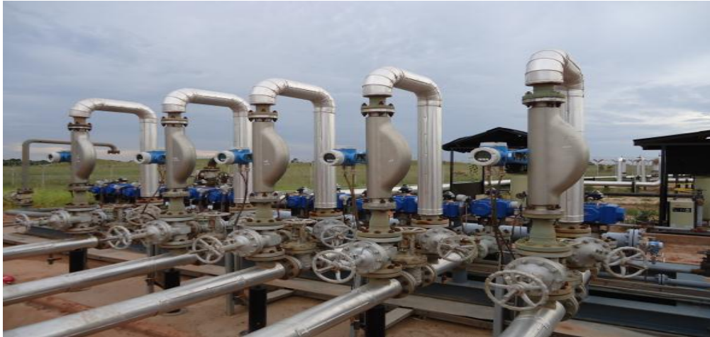
Figura 8: Cuadro típico de control de plantas procesadoras de crudo. Fuente: Ilvar Vanegas
