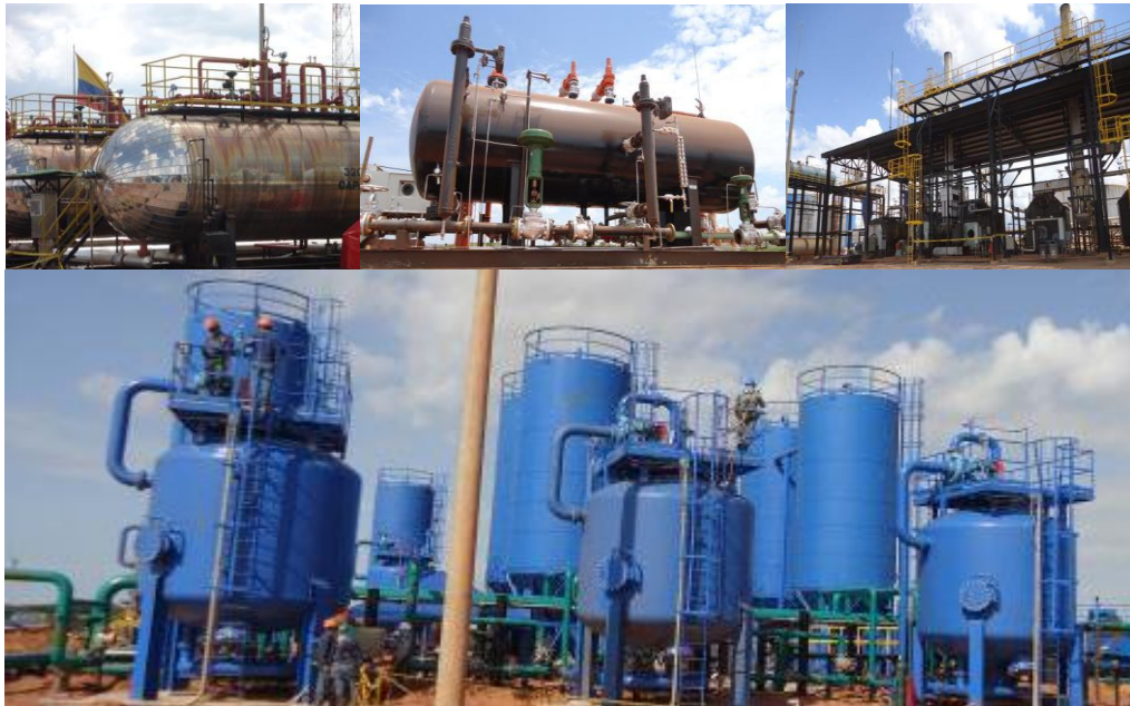
Figura 6: Recipientes a presión para la separación de crudo. Fuente: Ilvar Vanegas
