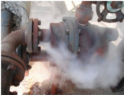
Figura 6. Daño extremo de seguridad.
