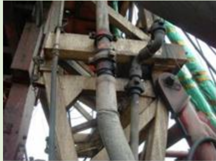
Línea de stand pipe
