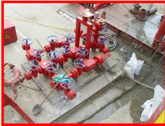
Choke manifold-(válvulas de estrangulamiento)
