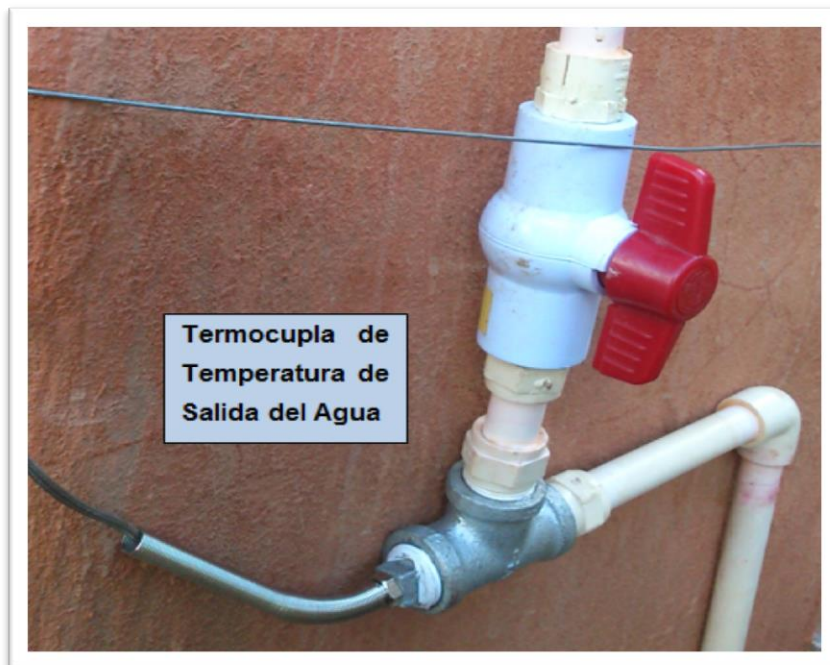
Figura 90. Ubicación termocupla temperatura de salida
