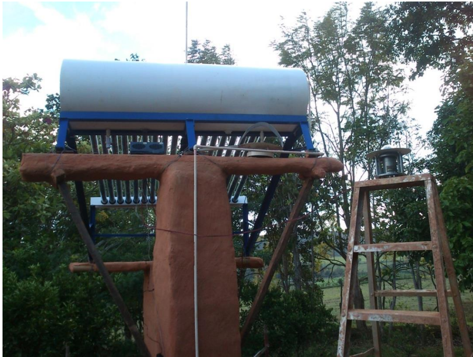
Figura 82. Sistema solar térmico posicionado
