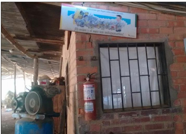
Imagen 27. Ubicación de extintores
