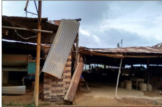
Imagen 8.Techos en mal estado.
