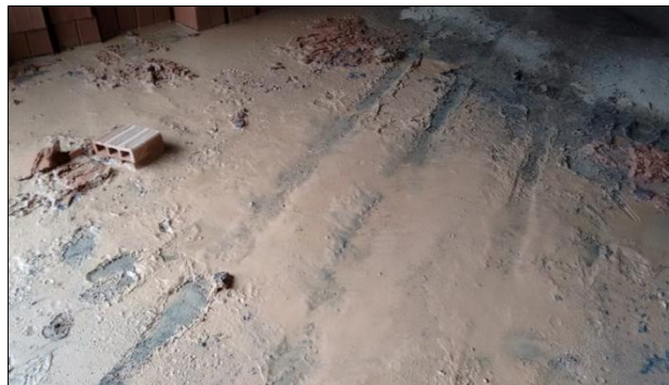
Imagen 12.Barro ocasionado por agua.
