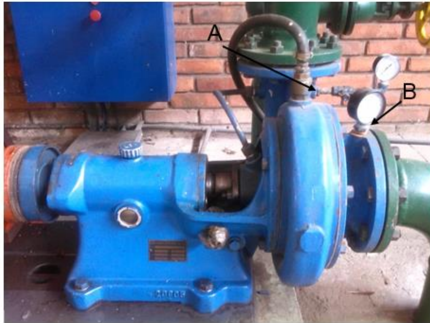
Figura 53 Vista lateral de la Bomba centrífuga.
