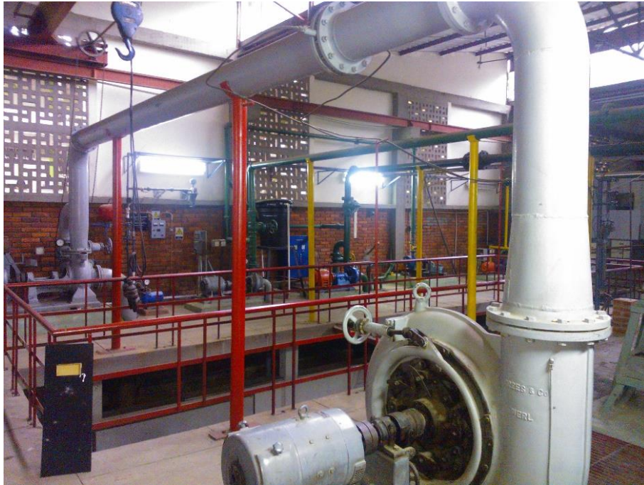
Figura 18 Banco de la Turbina Kaplan.
