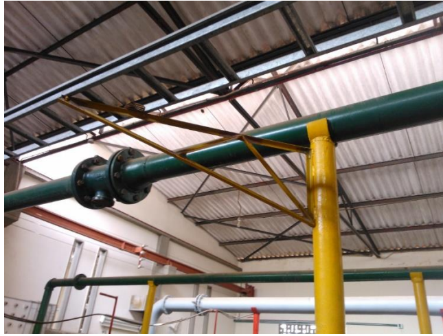
Figura 54 Tubería de transmisión.
