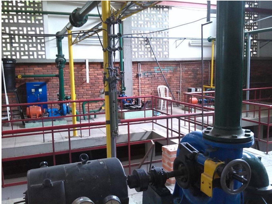
Figura 49 Banco de la turbina Francis.
