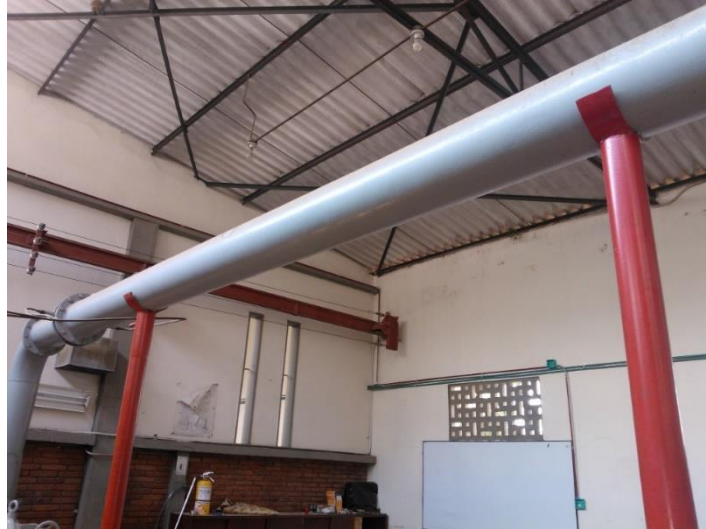
Figura 23 Tubería de transmisión.
