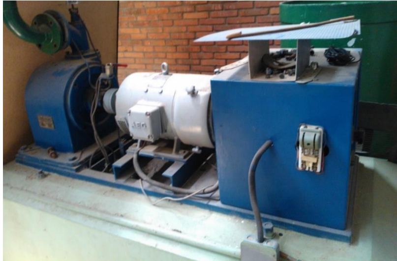
Figura 75 Sub-ensamble turbina Pelton.
