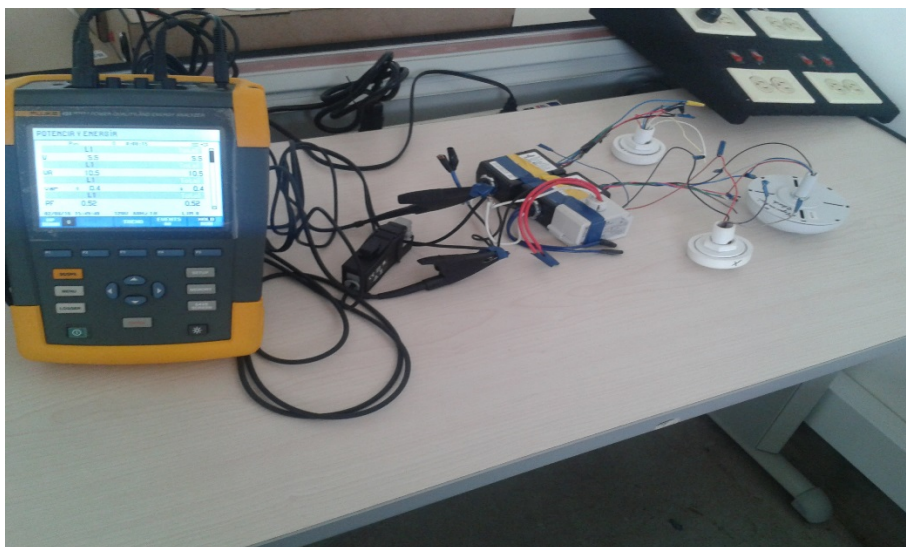
Figura D.3. Sensor, fotoceldas y power packs .
