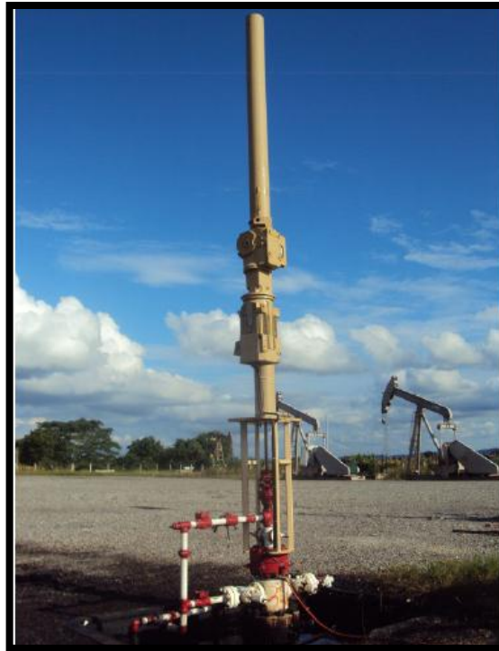
Figura 27. Unidad LRP correctamente instalada
