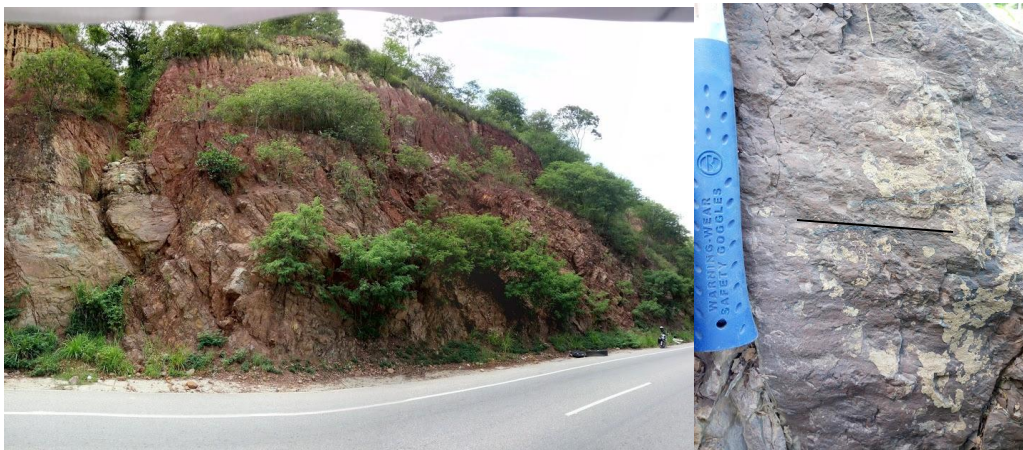
Figura 28. Evidencia de falla encontrada en la salida a Rionegro, en la vía que conduce al barrio Colorados.
