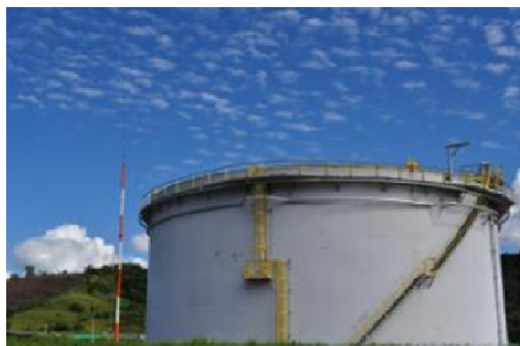
Figura 10 Tanque Almacenamiento CPF-Cupiagua
