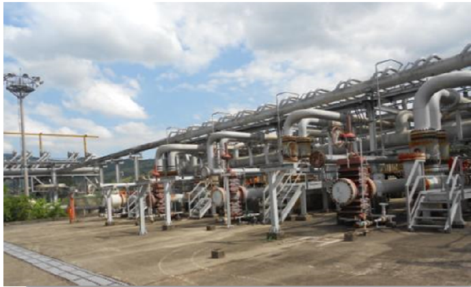
Figura 7 Llegada crudo CPF-Cupiagua
