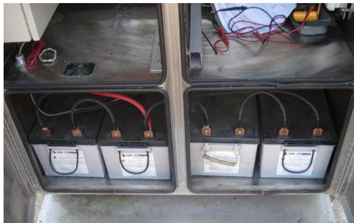
Figura 17 Baterías del sistema de energía solar
