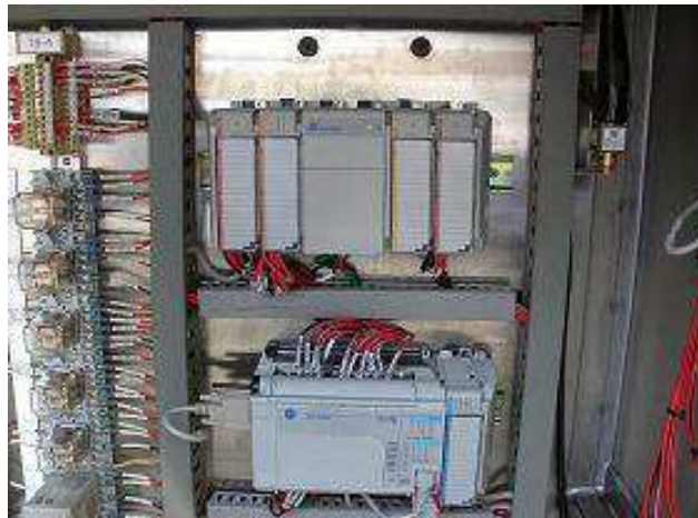
Figura 19 PLC WHCP pozo Cupiagua
