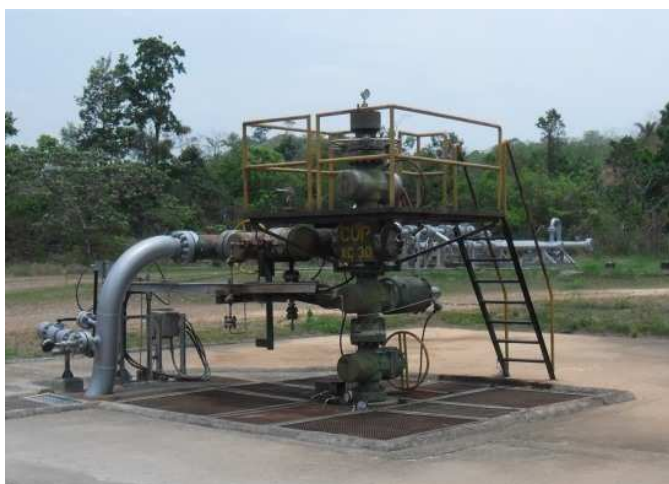
Figura 12 Pozo productor de petróleo Cupiagua
