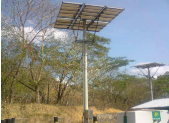
Figura 15 Paneles solares del WHCP
