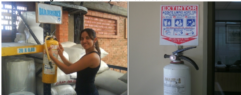
Imagen 8. Identificación y señalización de extintores.
