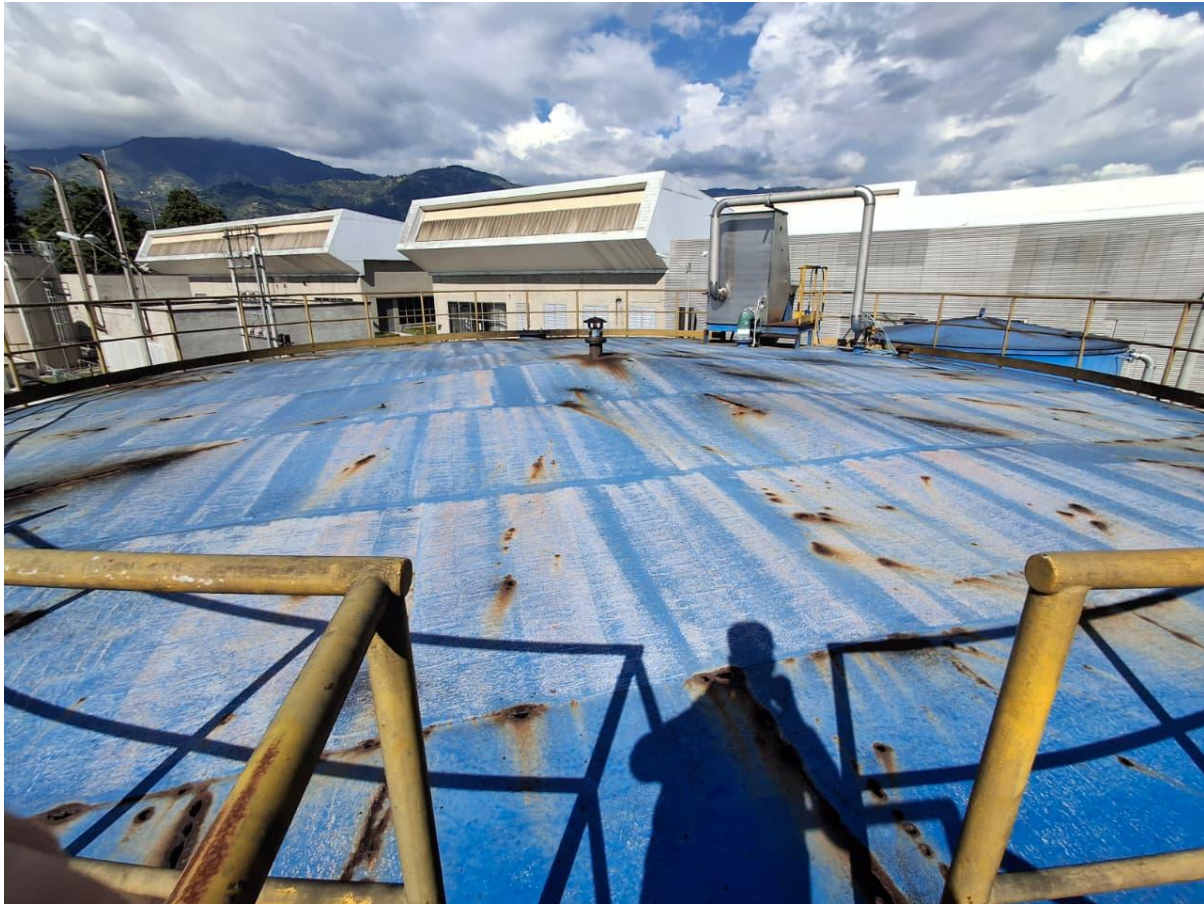
Figura 10 Estado del techo del tanque de ecualización de la PTAR
