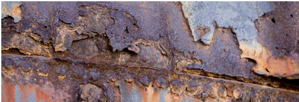
Figura 1. Efectos de la corrosión en la pared de una tubería.
