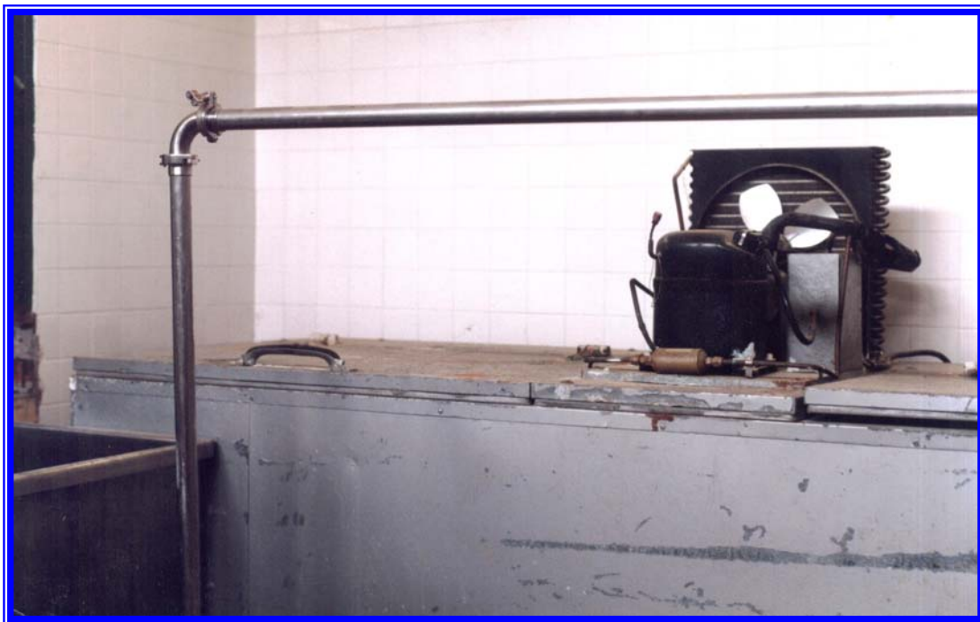
Tanque de enfriamiento
