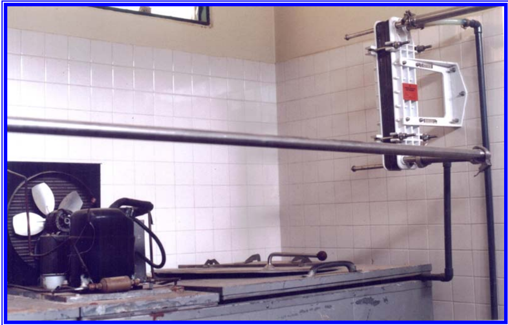
Tanque de enfriamiento
