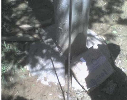
Foto 7 Sedimentación final de apoyos
