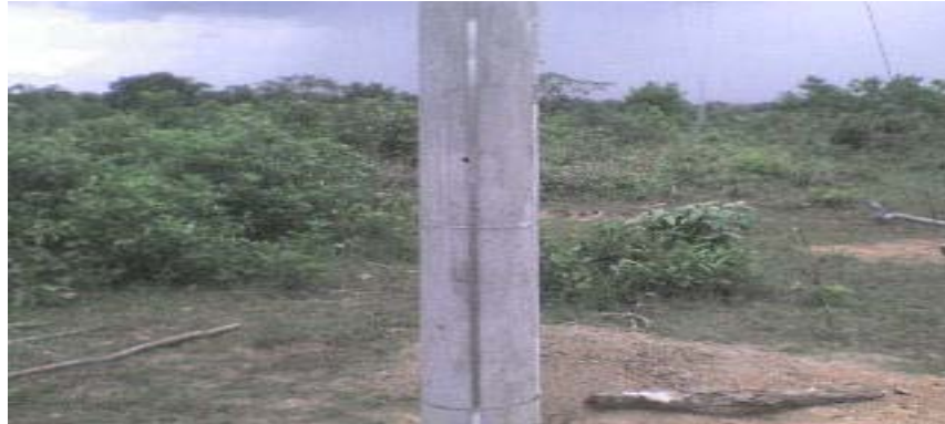
Foto 24 Cinta band en Acero para la puesta a tierra
