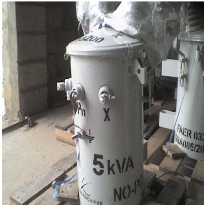
Foto 25 Transformador usado en la Mojana
