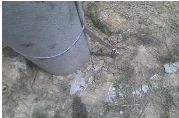
Fotografía No 19 Puesta a tierra
