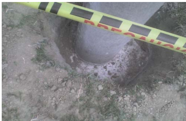
Foto 6 Sedimentación de apoyos
