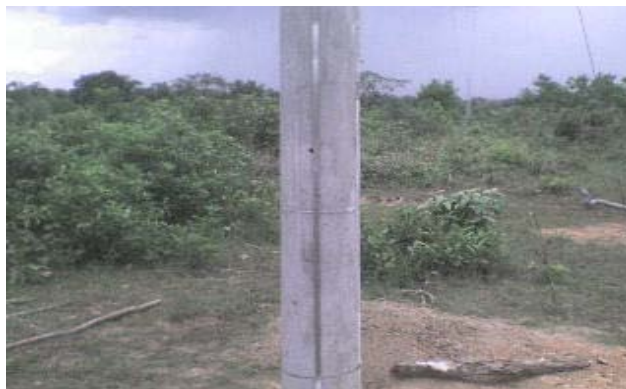
Fotografía No 20 Puesta a tierra
