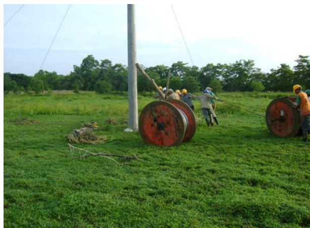
Fotografía 11 Carretes de cable
