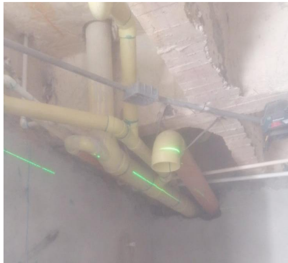
Figure 14. Interferencia tubería sanitaria y sistema drywall.
