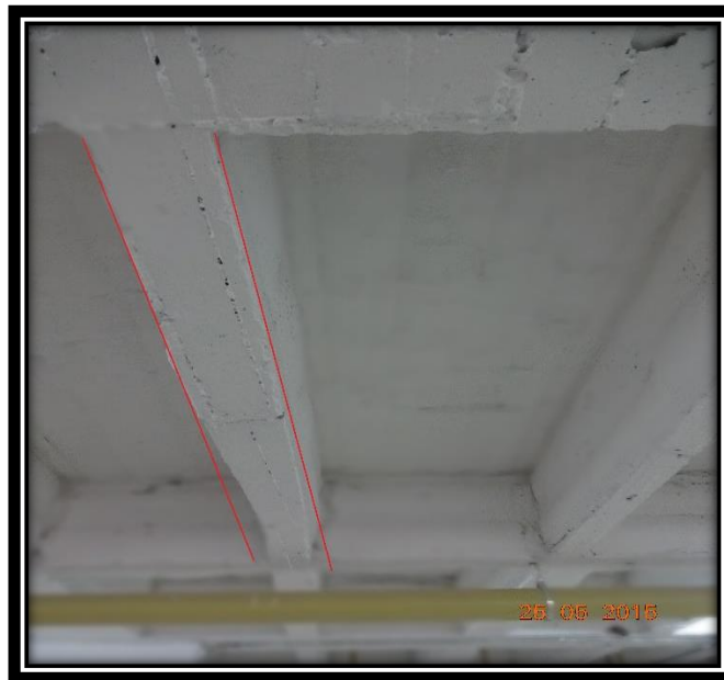
Imagen 12. Deformación en paredes laterales del casetón.
