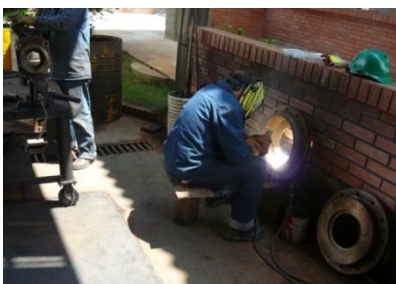
Foto 52. Puesto de soldadura antes
