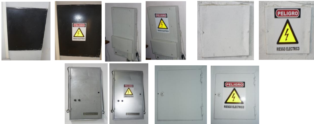
Foto 28. Señalización riesgo eléctrico
