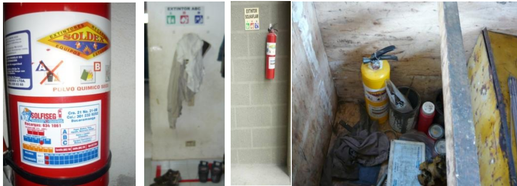
Foto 16. Evidencia inspección a extintores
