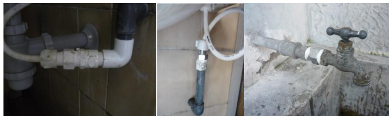
Foto 70. Válvulas ahorradoras de agua
