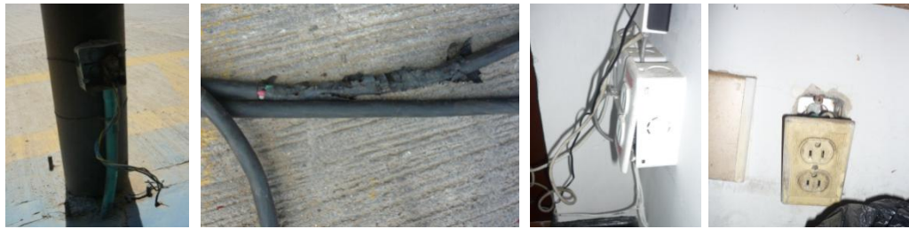
Foto 19. Evidencia inspección riesgo eléctrico
