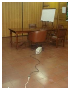
Foto 65. Cableado salón de Capacitación
