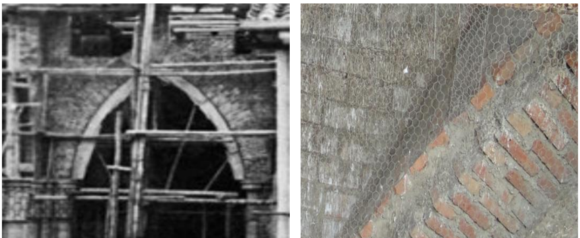
Figura 13. Arco en la etapa de construcción. Fuente: (Franciscanos de Bucaramanga 2012). Arco sobre balcón de las torres.
