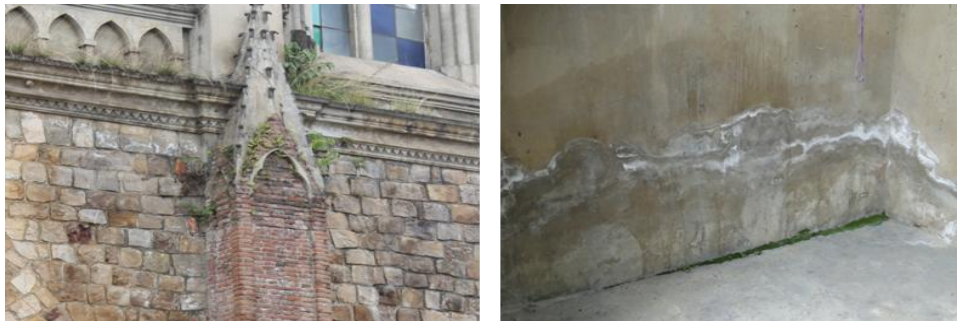
Figura 15. Crecimiento de la vegetación en la estructura. Fuente: el autor del proyecto.
