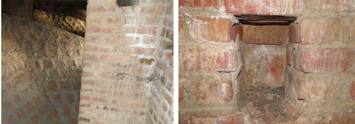
Figura 20. Mortero con proceso de carbonatación. Vista interna muro externo y columna interior rematada en ladrillo. Fuente: el autor del proyecto.
