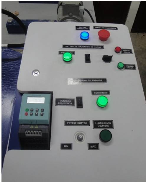
Figura 3.8.: Mandos del panel de control
