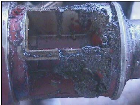
Figura 34. Sólidos acumulados en el Separador de Gas.
