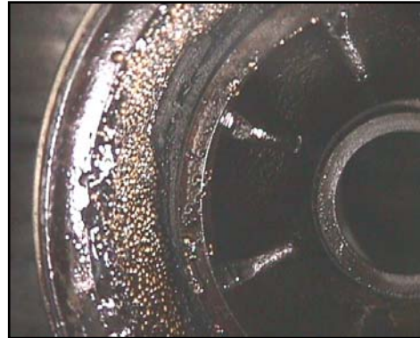
Figura 35. Sólidos acumulados en la bomba DN 1750.
