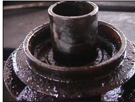
Figura 38. Bomba GN 4000 con ligera acumulación de sólidos.
