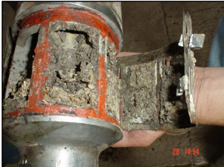
Figura 40. Acumulación de sólidos y Carbolita en la entrada del Separador.
