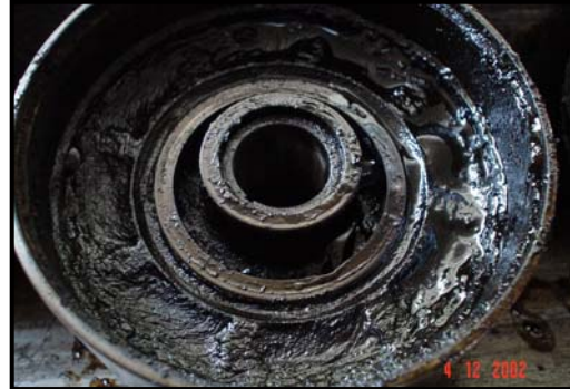
Figura 44. Acumulación de Carbonato de Calcio en las etapas de la bomba.
