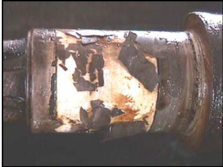
Figura 43. Presencia de Carbonato de Calcio en el eje de la bomba.
