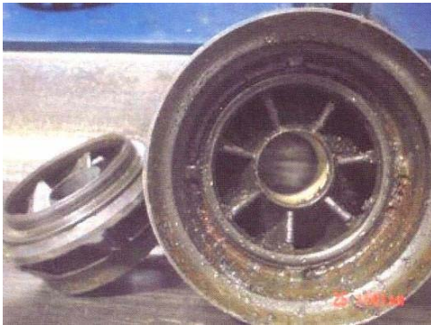
Figura 54. Bomba con desgaste por downthrust.
