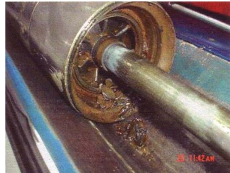
Figura 55. Acumulación de sólidos en la bomba – Orito 115.
