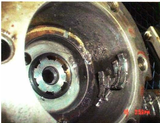
Figura 52. Estado del motor – Orito 113.
