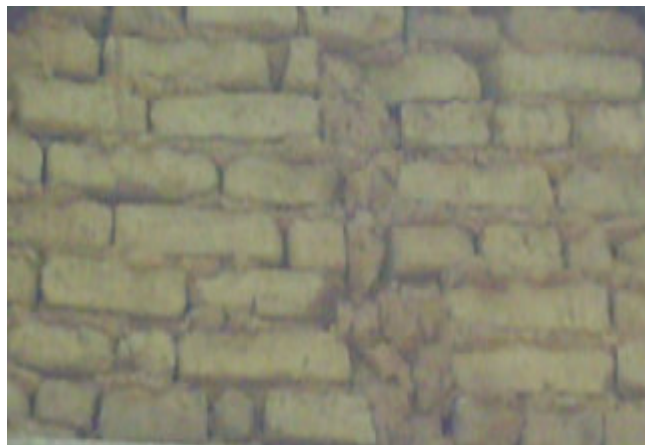
Figura 68. Carencia de uniformidad. Fuente: Autores del proyecto.
