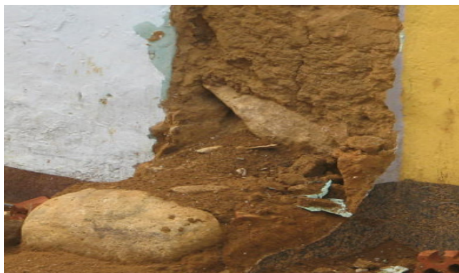
Figura 71. Carencia de conexión entre el muro y la cimentación. Fuente: Autores del proyecto.
