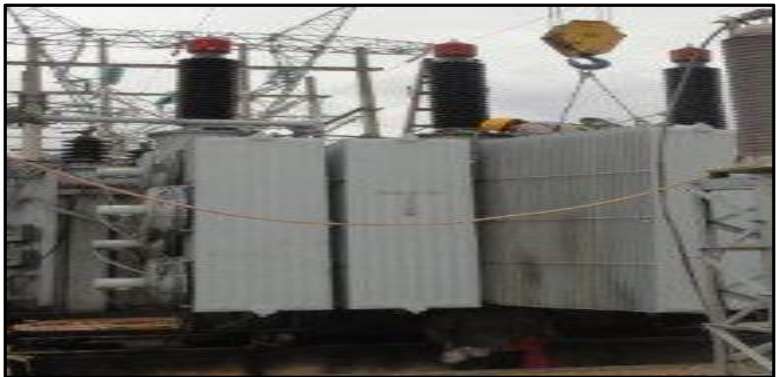
Fuente: subestación Bucaramanga
