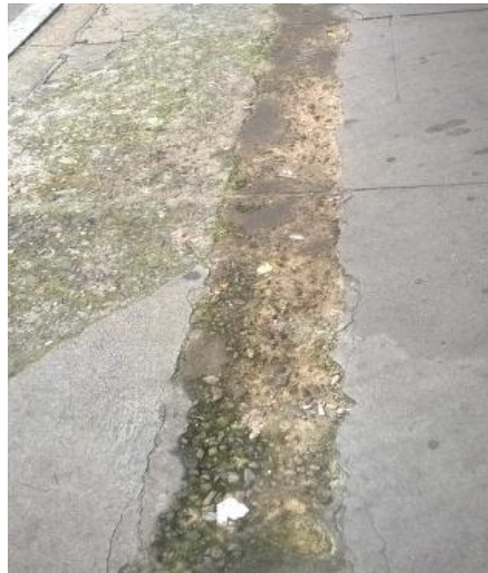
FIGURA3: Estado de la superficie de un andén en la zona de estudio.
