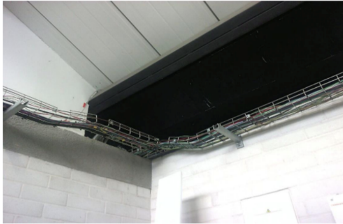
Figura 62. Sistema de cableado interno [40].
