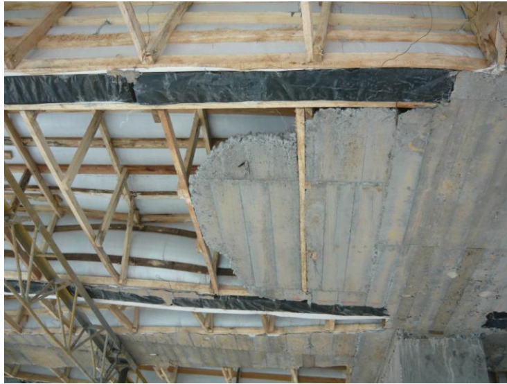
Figura 29. Paca fundida con casetón en madera de mala calidad
