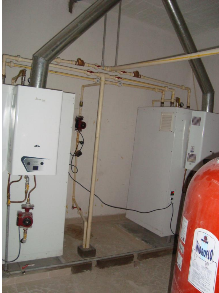
Figura 43. Equipo central de calentamiento de agua a gas de Dubai
