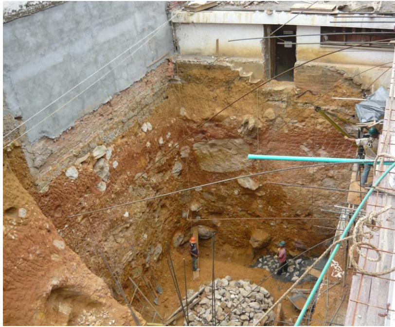
Figura 2. Registro del buen suelo de fundación y las enormes rocas que contiene
