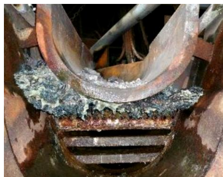
Figura 19. Acumulación de costras en la punta de la canal refrigerada.
