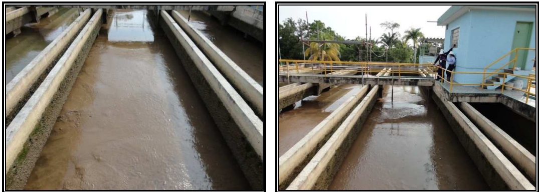
Figura No. 10 Lodos presentes en los decantadores.
