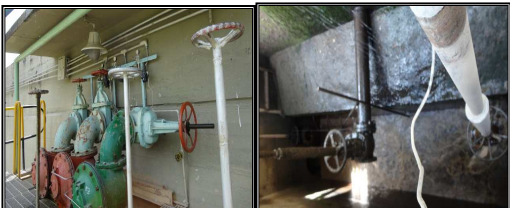
Figura No. 13 Válvulas para purga de lodos: laterales, fondos y campanas – decantador No. 2.
