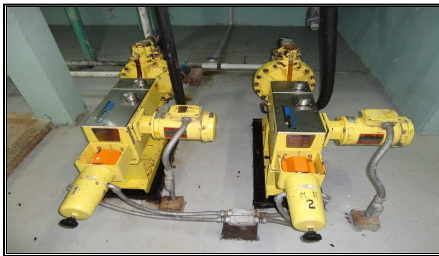
Figura No. 4 Bombas dosificadoras de coagulante.
