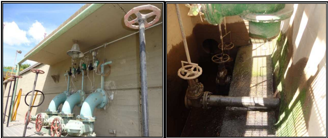
Figura No. 12. Válvulas para purga de lodos: laterales, fondos y campanas – decantador No. 1.
