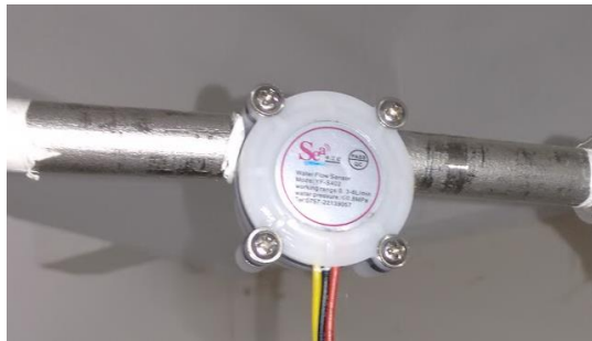
Figura 9. Sensor de flujo en la entrada del reactor
