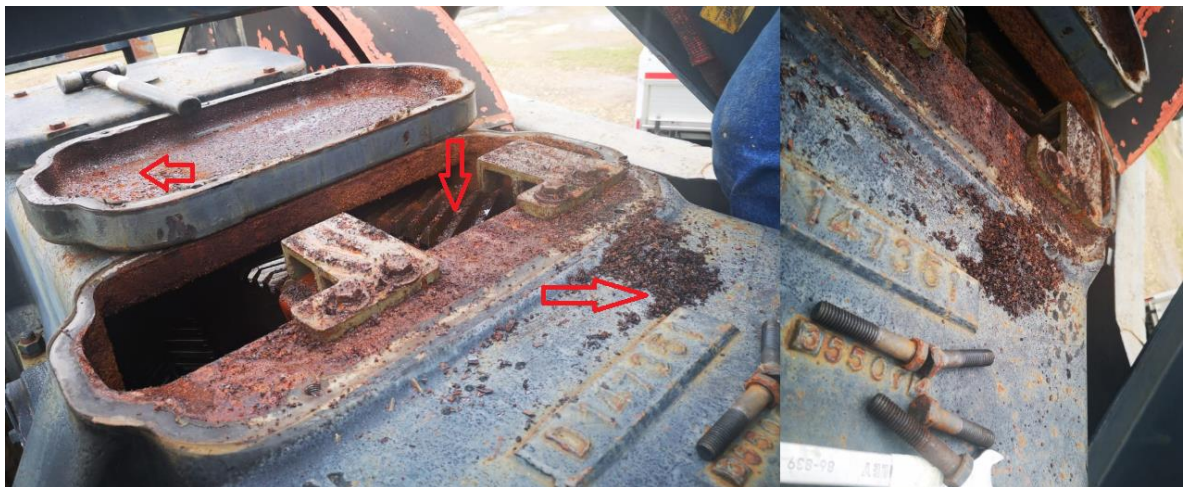
Figura 16. Hallazgo de herrumbre dentro de la casa reductora.
