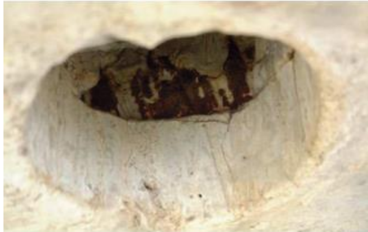
Figura 17. Ducto de un cable de presfuerzo expuesto en la losa inferior. Tomado de [49]
