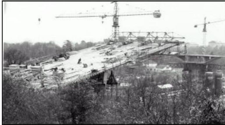
Figura 22. Inclinación del primer voladizo del viaducto sobre el Viosne (Francia, 1970). Tomado de [19]
