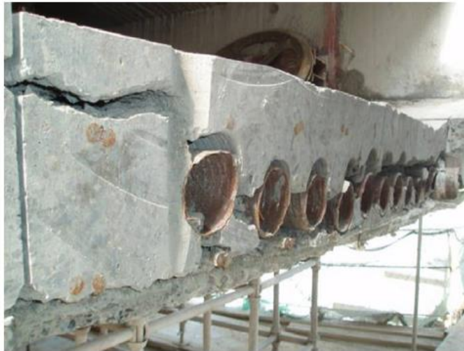
Figura 20. Agrietamiento del concreto y falla y separación transversal de los ductos de los cables de pretensado en la losa inferior. [52]
