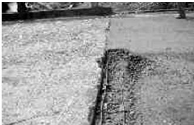
Figura 14. Daño en junta entre losa de aproximación y tablero. Puente el Tapón. Tomado de [8]
