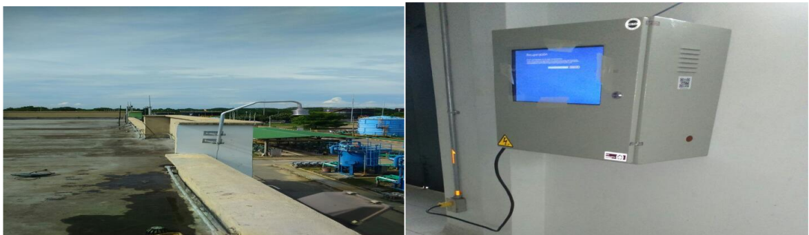
Figura 26. Instalación sistema Prethorview en subestación PIA
