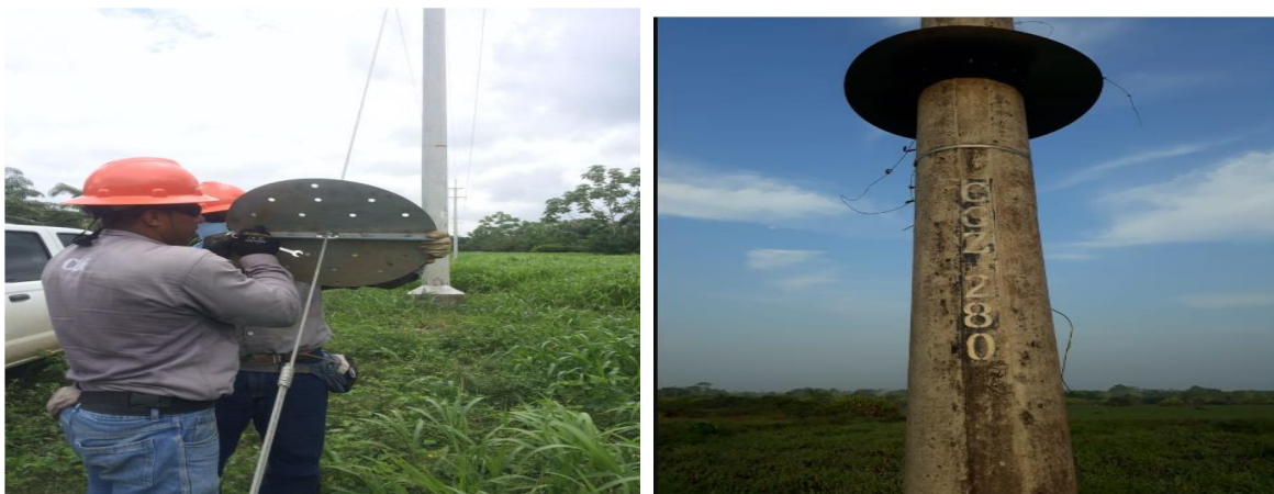
Figura 36. Elementos para impedir acceso a las estructuras
