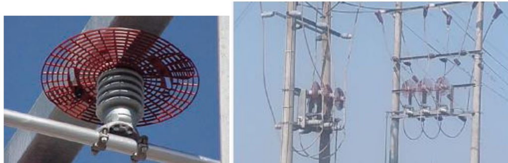
Figura 15. Bus isolation squirrel; Bus isolation squirrel instalado en estructuras de enlace cluster 12 campo Yariguí
