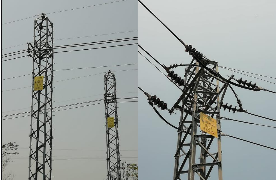
Figura 28. Circuito hacia Isla 1 en cable semi aislado
