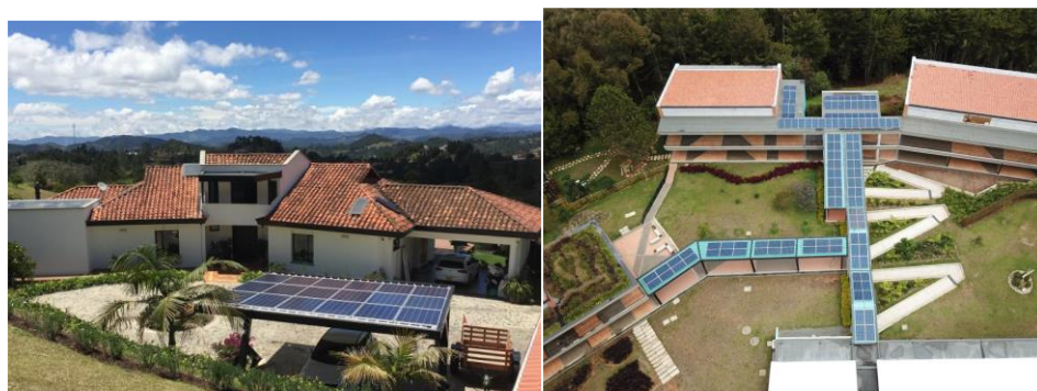
Figura 7. Instalación de paneles en techo de parqueadero de una casa campestre (izquierda) y en el techo de un sendero peatonal (derecha). Adaptado de ERCO.
