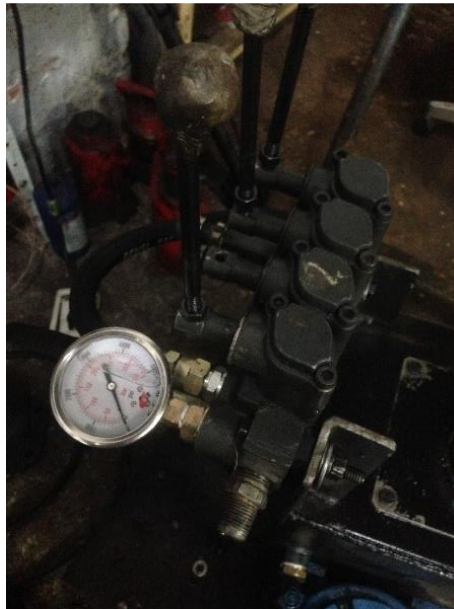
Figura 60. Batería de válvulas marca GHIM, modelo ADT-K8-0114
