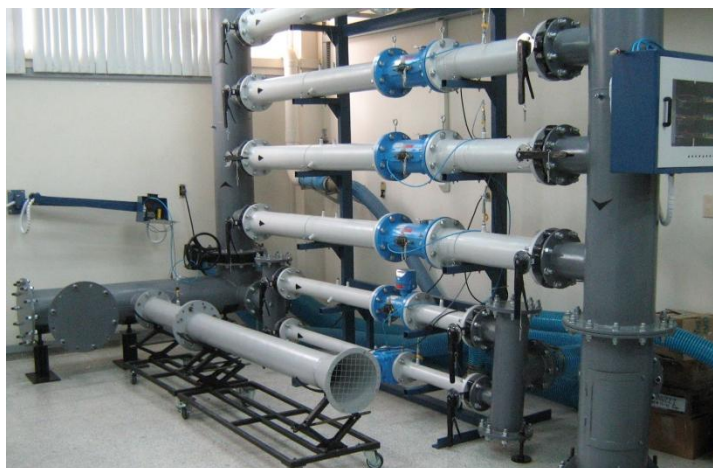
Figura 2. Banco de Calibración de Medidores de Flujo y/o Volumen de Gas de la Corporación CDT de GAS
